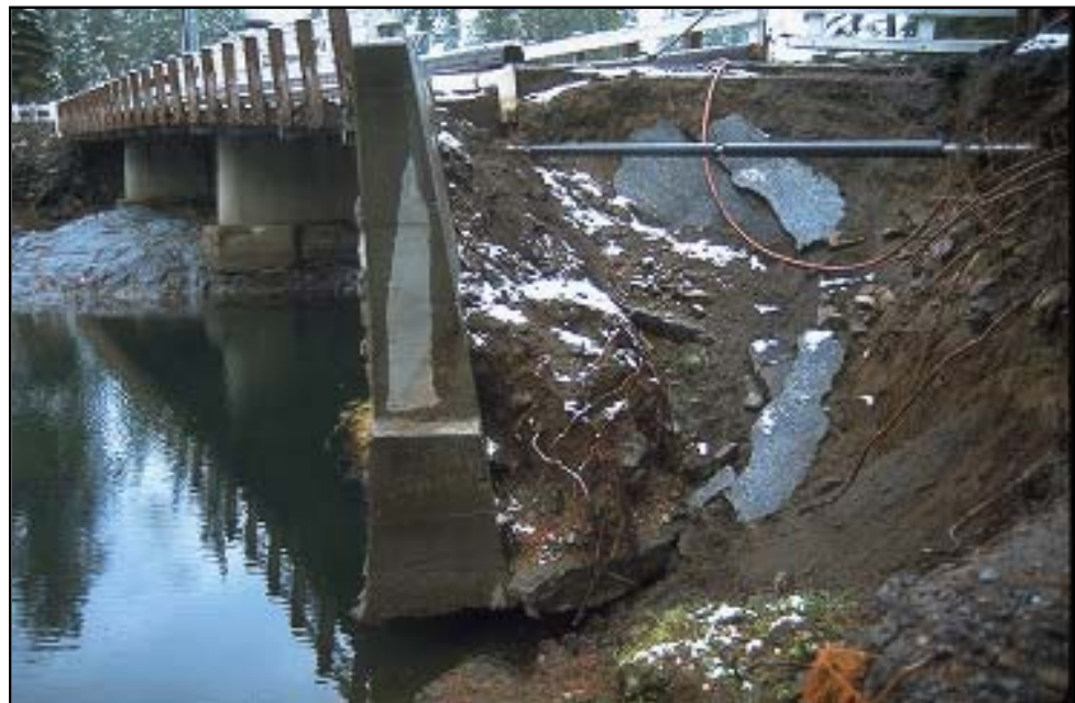
Foto 6.1 Socavación de un suelo fino detrás del estribo de un puente, causada por una protección insuficiente de las márgenes del arroyo durante una tormenta.
