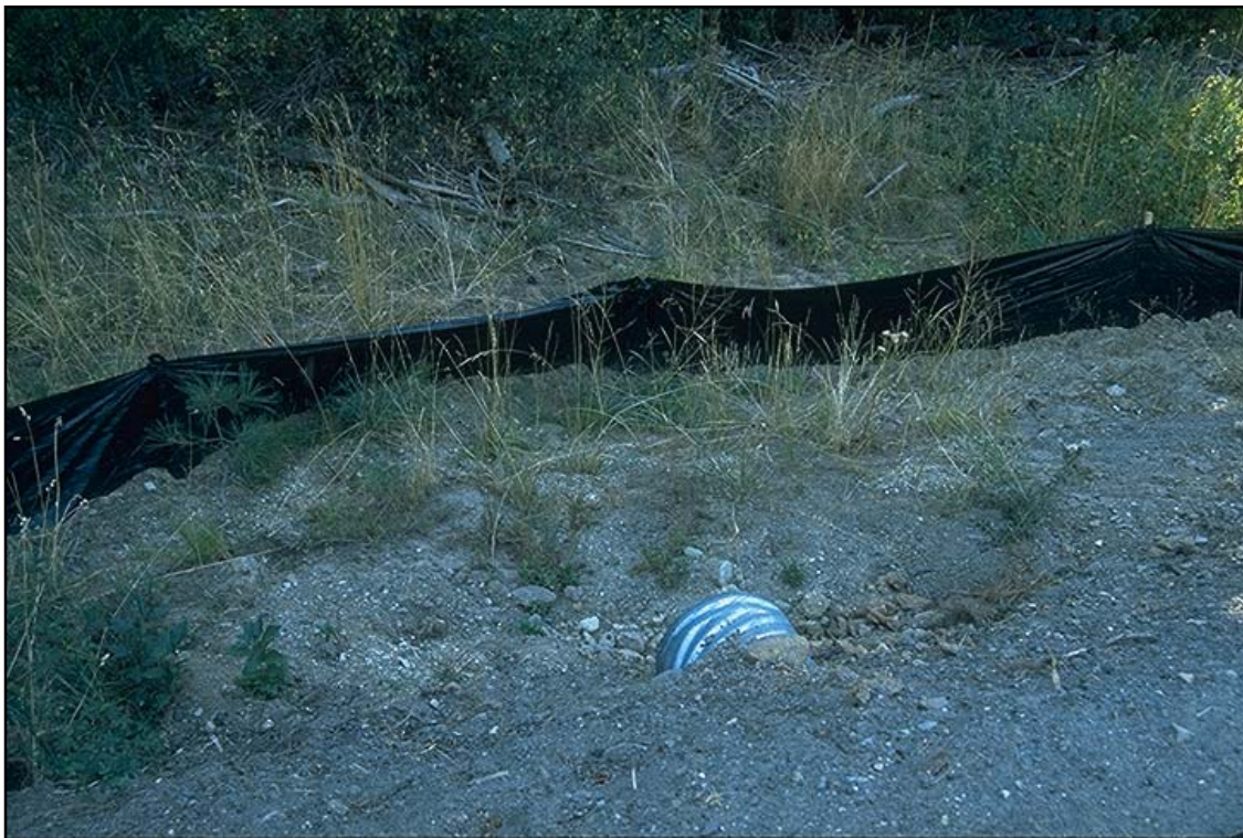
Foto 6.6 Uso de geotextiles como “barreras contra asolves” para atrapar sedimentos de una zona en construcción.
