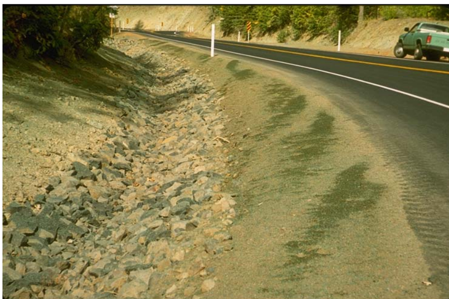
Foto 3.5 Se deberá dar mantenimiento a los caminos y a las obras de drenaje para resistir los efectos de grandes tormentas con una erosión mínima, por ejemplo con enrocamientos de protección en las cunetas, las cuales deben mantenerse limpias.
