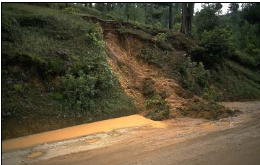
Foto 4.11 Retire el material de los deslizamientos que bloqueen las cunetas de drenaje y que reduzcan el ancho del camino.
