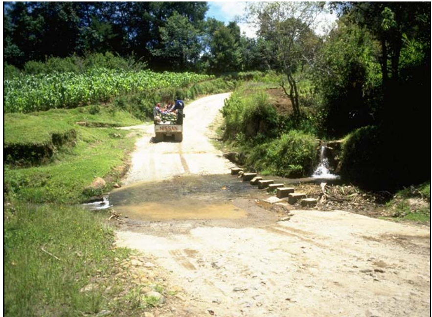
Foto 9.1 Use cruces acorazados para temporadas de estiaje o vados con la mayor frecuencia posible, para cruzar caudales bajos en desagües naturales anchos y poco profundos para evitar el uso de tubos. Note que la superficie de este cruce requiere reparación.
