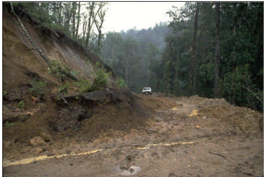
Foto 1.3 Camino problemático debido a fallas en los cortes del camino. Los problemas de inestabilidad ocasionan retrasos en los usuarios del camino y altos costos de mantenimiento o de reparación.
