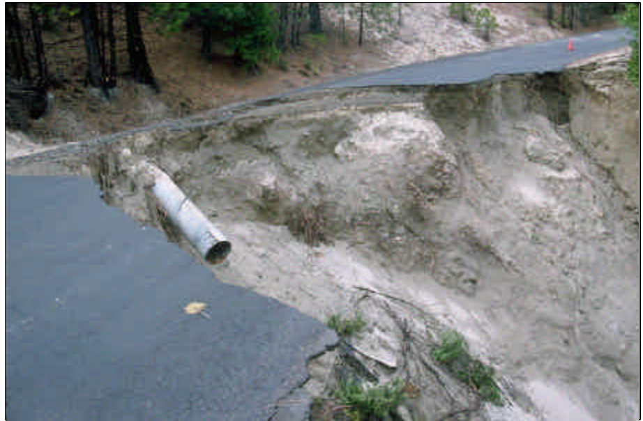
Foto 11.10 Falla del relleno de un camino en terreno escarpado, para el que ahora se requiere una estructura de contención o una gran corte alto para alojar el camino al rededor de la falla.
