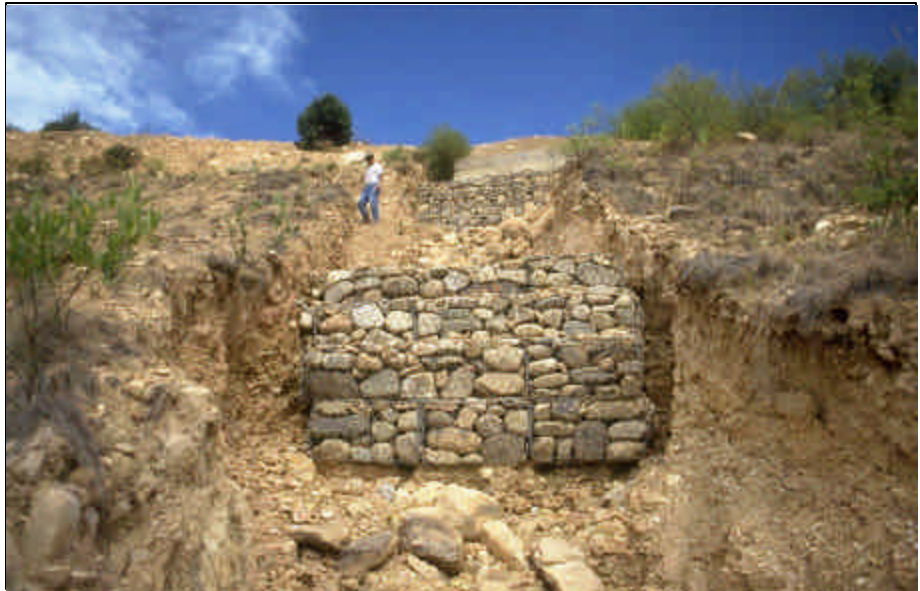
Foto 14.3 Una estructura cara pero infructuosa de gaviones de control de formación de barranquillas, que no se anclaron debidamente en las márgenes de las mismas, y tampoco se mantuvo el flujo por encima de la parte media protegida por la estructura.
