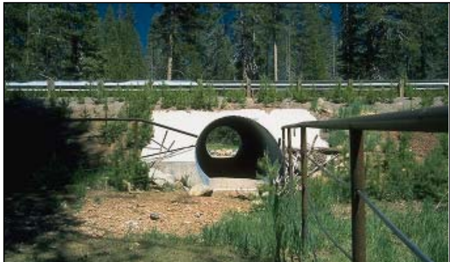
Foto 2.7 Una alcantarilla de paso inferior construida para permitir que los animales se desplacen con seguridad entre ambos lados del camino.
