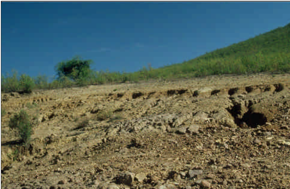
Foto 12.11 Esta zona de préstamo al lado del camino carece de control del drenaje y de la erosión. El desarrollo de pedreras a un lado del camino puede resultar económico y útil, pero las áreas deben esconderse si es posible, y la zona deber rehabilitarse una vez concluido el proyecto.
