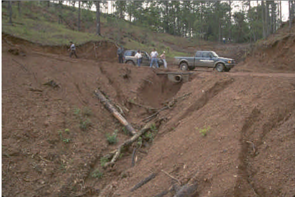
Foto 8.9 Evite colocar bocas de salida de alcantarillas en la parte media de una talud de terraplén. Use alcantarillas lo suficientemente largas para sobresalir del pie del talud del terraplén, o use estructuras de muros de cabeza para retener el material de relleno y minimizar la longitud del tubo.
