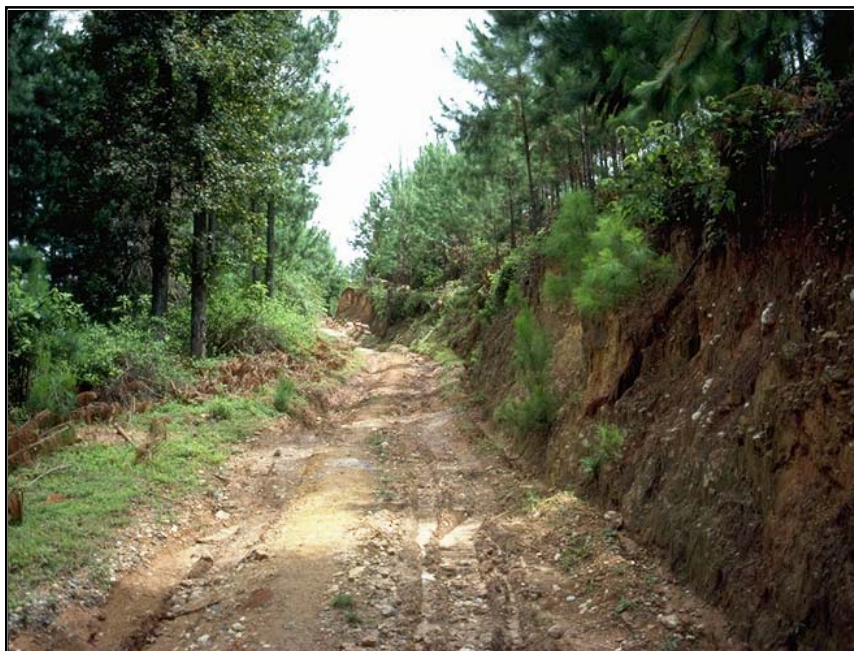
Foto 12.1 Camino con roderas causadas ya sea por un suelo blando de subrasante o por drenaje inadecuado del camino (o ambos).
