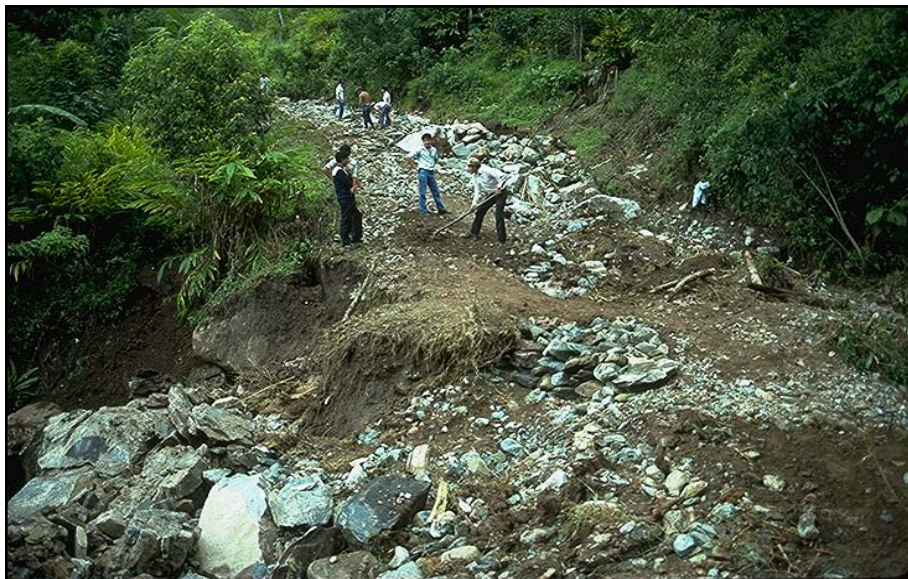
Foto 3.4 Camino que ha sufrido grandes daños durante una tormenta, debido al tamaño insuficiente del tubo de alcantarilla, que se tapó y a la falta de protección contra desbordamiento.
