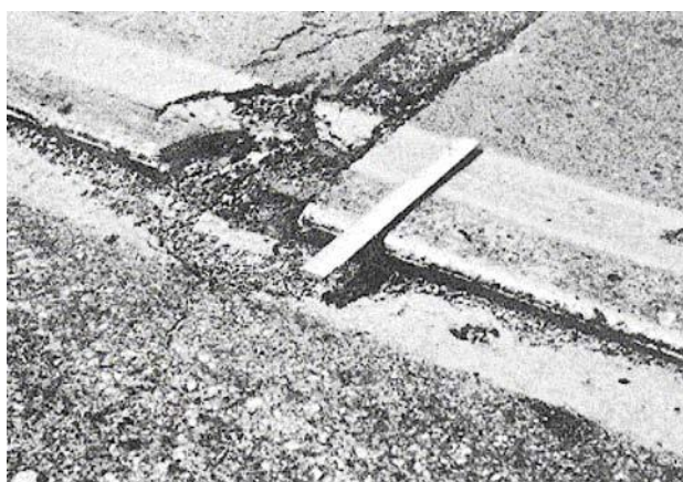
Figura C-7.a. Caída Externa de Vía / Hombarrera Baja-severidad.
