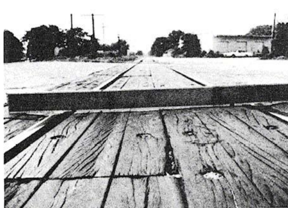
Figura B-14.a. Cruce de Ferrocarril Baja-severidad.
