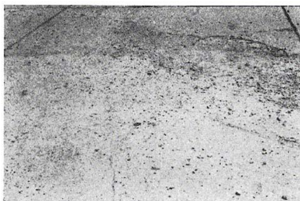
Figura C-4.c. Agrietamiento (“D”) de Durabilidad Alta-severidad.
