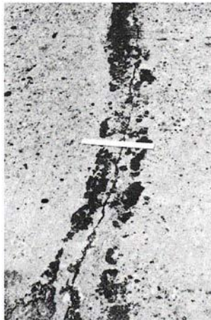
Figura C-8.a. Agrietamiento Lineal Baja-severidad.
