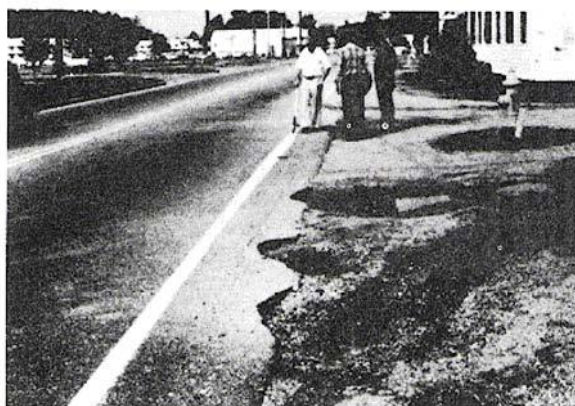
Figura B-7.c. Agrietamiento de Borde Alta-severidad.
