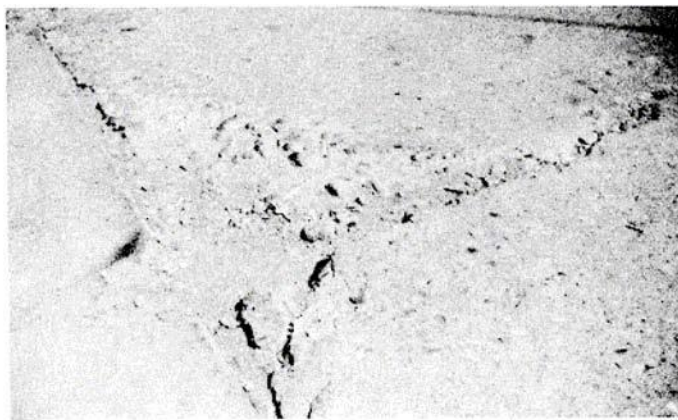
Figura C-18.c. Escamadura de Esquina Alta-severidad.
