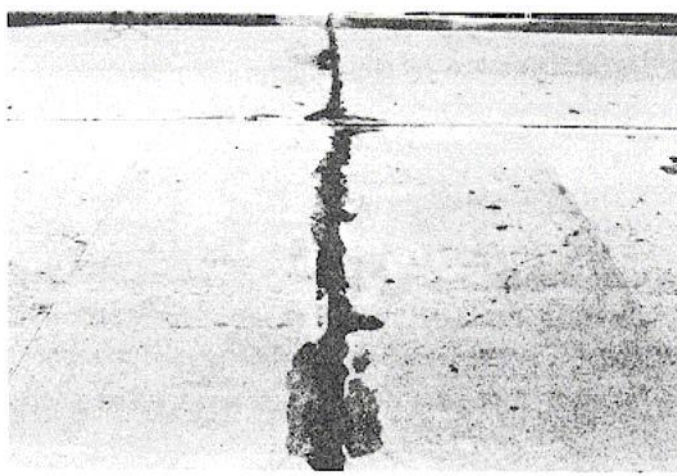
Figura C-6.a. Daño del Sello de Junta Baja-severidad.
