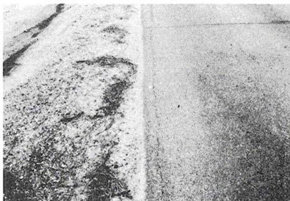
Figura B-7.a. Agrietamiento de Borde Baja-severidad.
