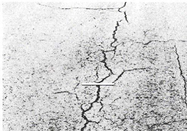
Figura B-10.b. Agrietamiento Longitudinal y transversal Media-severidad.
