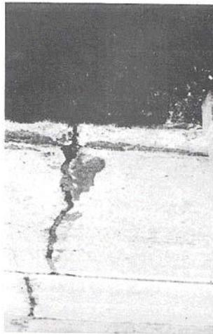
Figura C-8.b. Agrietamiento Lineal Media-severidad.
