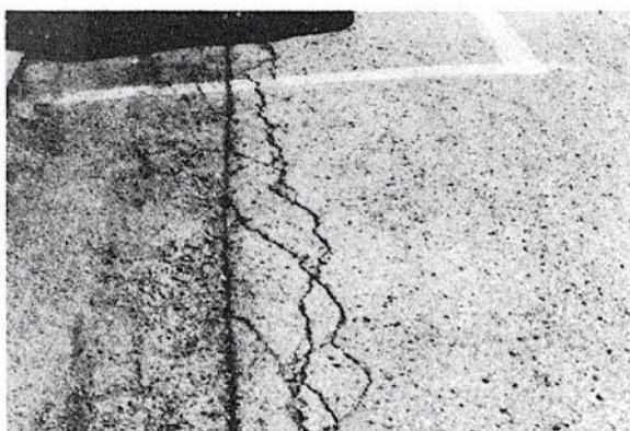
Figura B-7.b. Agrietamiento de Borde Media-severidad.
