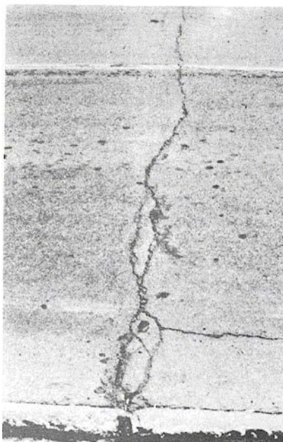
Figura B-8.b. Agrietamiento Reflejo de Juntas Media-severidad.
