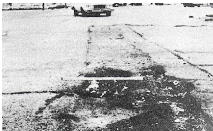
Figura B-11.c. Parchados Alta-severidad.
