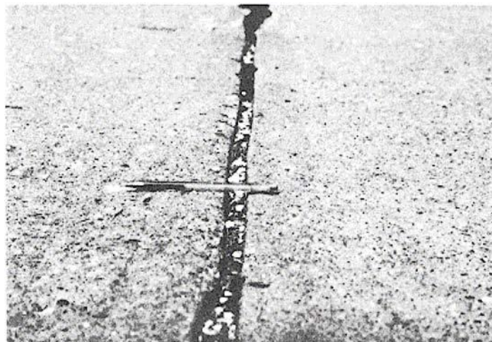
Figura C-6.c. Daño del Sello de Junta Alta-severidad.
