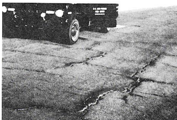
Figura B-3.c. Agrietamiento en bloque Alta-severidad.
