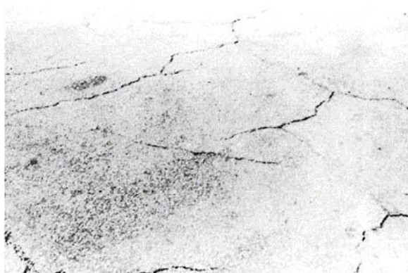
Figura B-3.a. Agrietamiento en bloque Baja-severidad.
