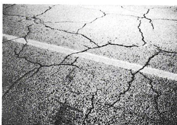
Figura B-3.b. Agrietamiento en bloque Media-severidad.
