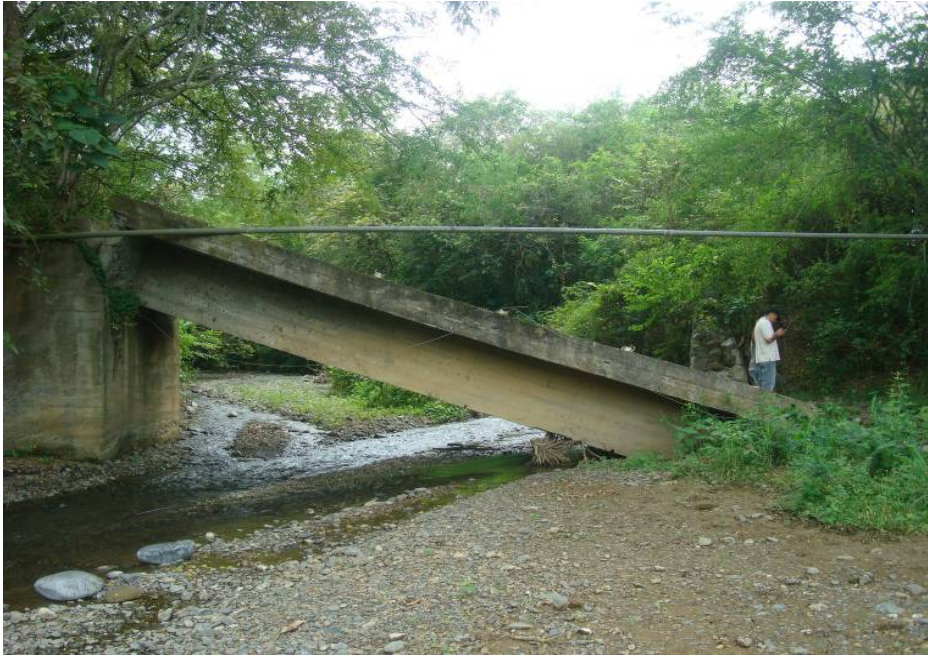
Figura 6.7. - Pontón colapsado sobre la quebrada La Lucha por socavación local de uno de los estribos, en la vía que comunica el Municipio de Leiva con la Vereda Martín Pérez en el Departamento de Nariño.
