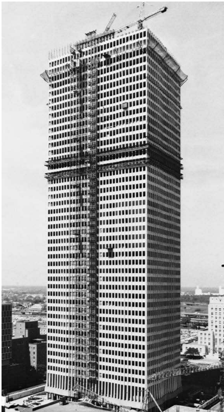
Plaza One Shell, Houston, Texas, que tiene 52 niveles y una altura de 714 pies. (Cortesía de BASF Corporation.)
