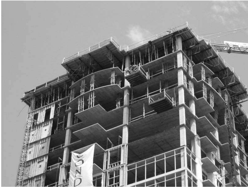
Construcción con placa plana: Condominios Pharr Road, Atlanta, GA. (Cortesía del Prof. Larry Kahn, Georgia Institute of Technology.)
