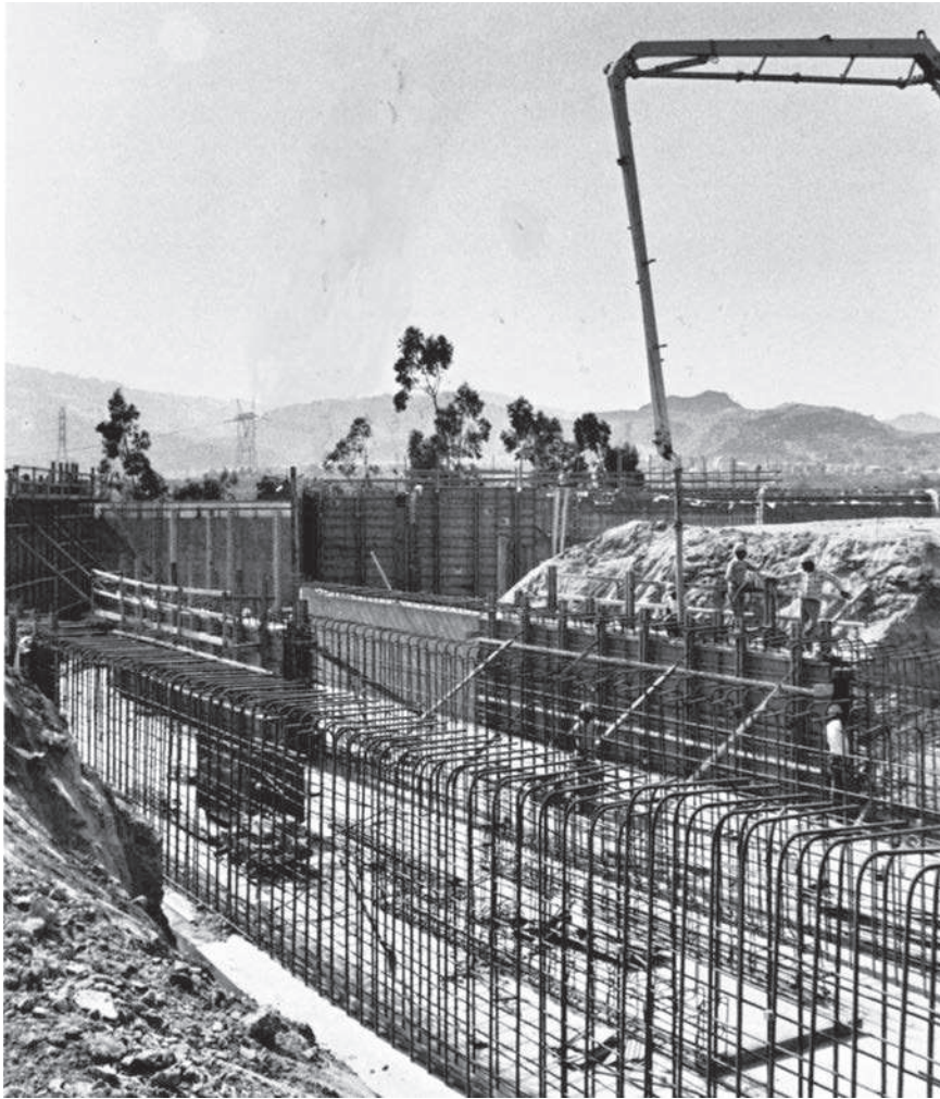
Proyecto hidráulico en el Condado de Los Ángeles. Cortesía de Aluma Systems/Brand Energy & Infrastructure Services.
