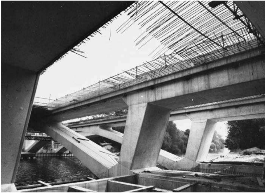
Puente Runnymede de concreto presforzado sobre el Río Támesis, cerca de Egham, Surey, Inglaterra. (Colección CC&A, cortesía de The Concrete Society.)
