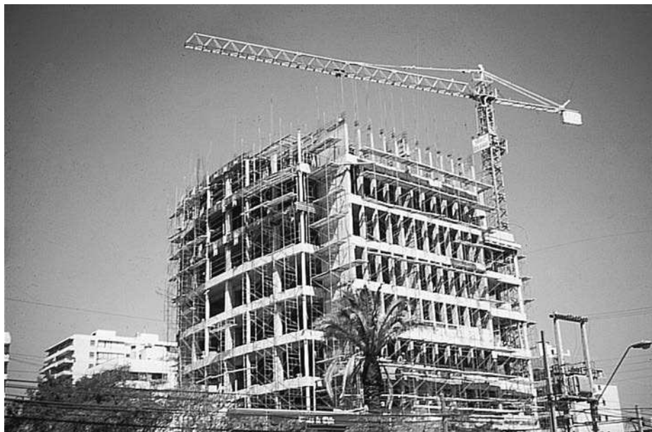
La Torre Apoquindo de 16 niveles, en Santiago, Chile. (Cortesía de EFCO Corp.)
