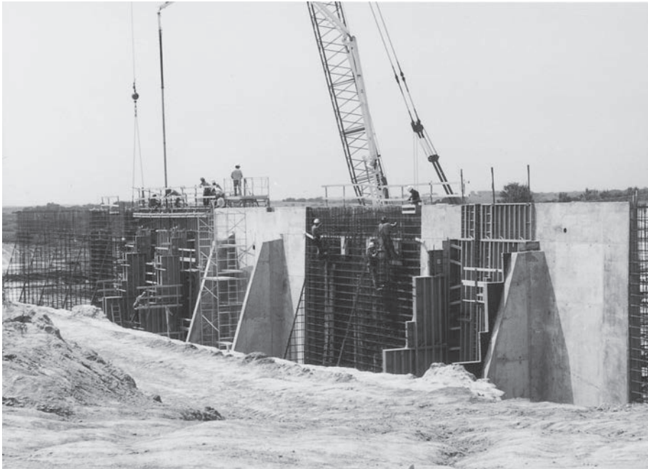
Muros de cimentación de treinta y dos pies de alto para el MCI Mid-Continent Data Center en Omaha, Nebraska. (Cortesía de Economy Forms Corporation.)
