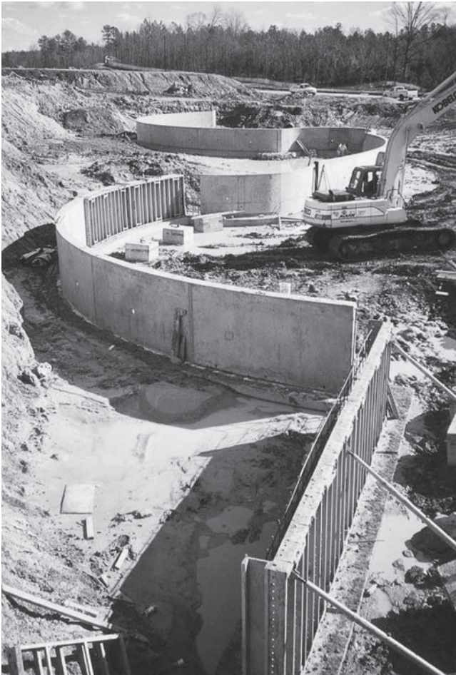
Planta de agua potable de la punta sur, Durham, NC. (Cortesía de EFCO.)
