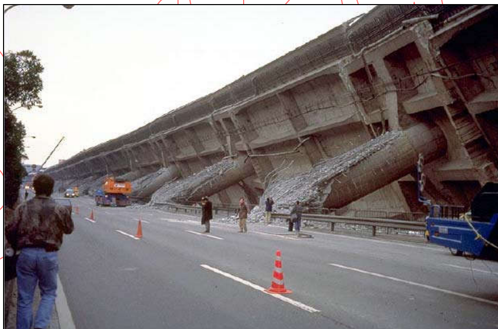
Figura 4.1 Colapso de una autopista elevada en el terremoto de Kobe, Japón, 1995 Cortesía del Earthquake Engineering Research Institute, EERI
