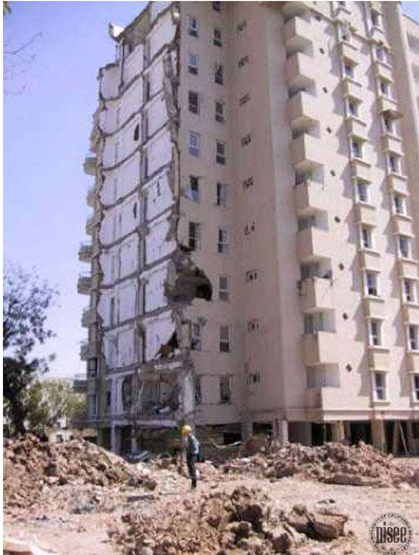
Figura 7.37 Manpostería dañada en edificio de departamentos, Bhuj 2001, India
