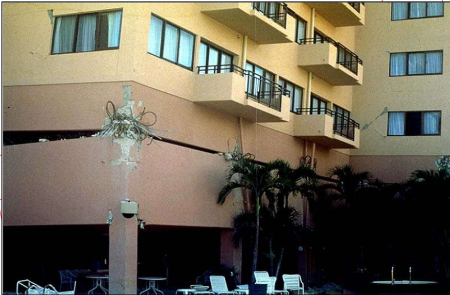
Figura 7.32 Colapso de segundo piso debido a los altos alfeizares que producen el fenómeno de columna corta, terremoto de Guam 1993.
