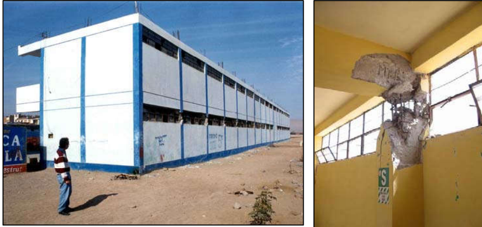
Figura 7.29 Problemas de columna corta en edificación escolar. Tacna, Peru 2001.
