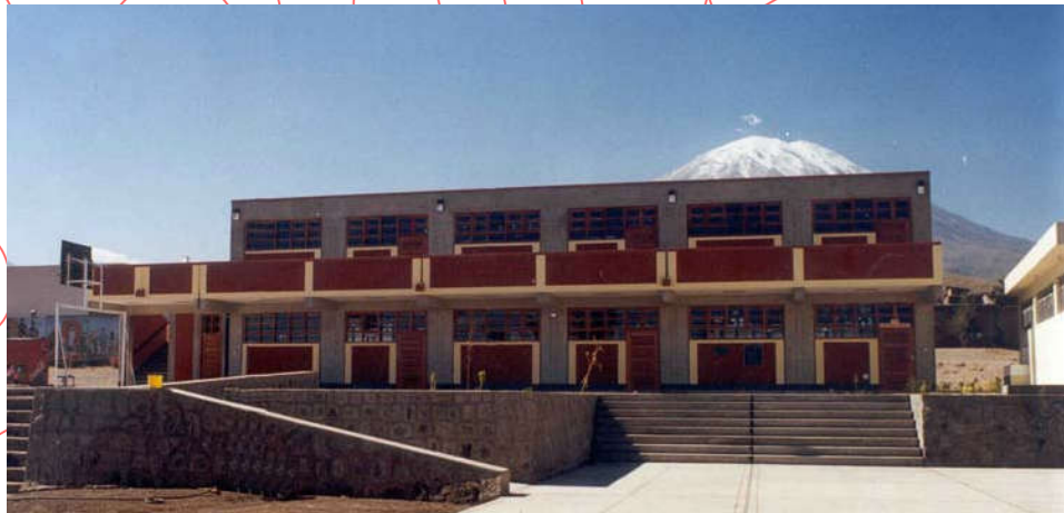
Figura 6.10 Edificio educativo en el sur del Perú sin daño luego del terremoto de Atico en el 2001, M_w= 8.4
