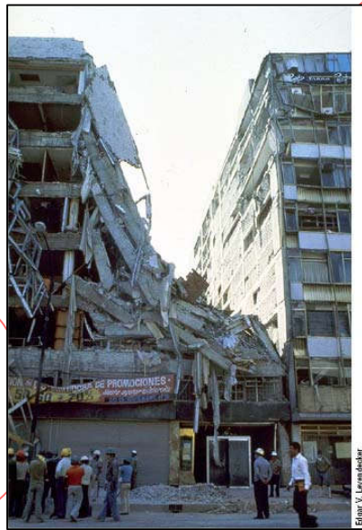
Figura 7.34 Golpeteo entre edificios colindantes. México 1985
