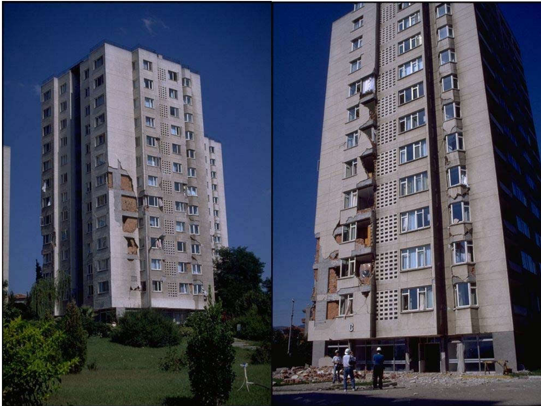
Figura 7.38 Muros Daño en mampostería en edificio de departamentos, muros de tabaquería dañados. Izmir 1999, Turquía.
