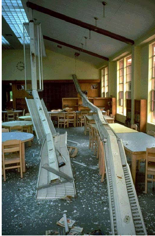
Figura 7.42 Caída de lámparas de iluminación en colegio
