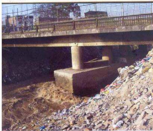
Figura 10.19 Detalle del desmonte acumulado en el cauce del río Rímac, bajo el Puente Bella Unión.
