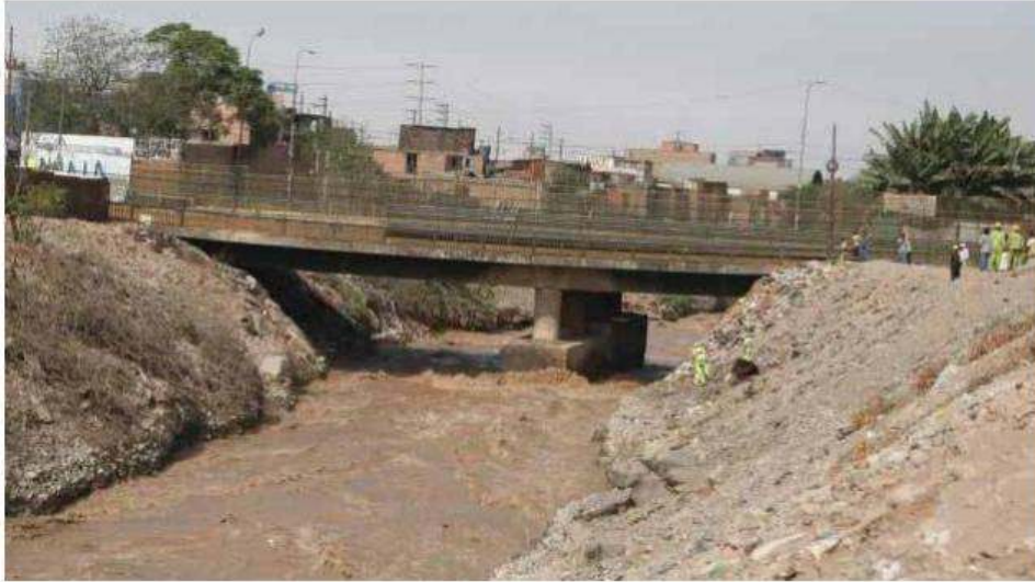
Figura 10.18 Desmonte acumulado en el cauce del río Rímac, bajo el Puente Bella Unión (2013).
