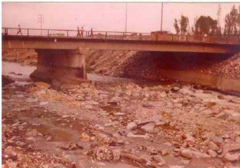
Figura N° 10.5 Puente Dueñas (Río Rímac). Se observa la profundización del cauce (1983).
