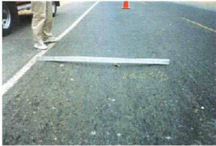
FOTO N° 3 Ahuellamiento severo medido con una regla de aluminio de 1,20 m de longitud y la depresión con una cinta métrica.
