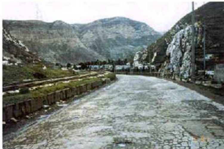
CONDICION N° 9 Muy Malo CONDICION N° 10 Pésimo.
