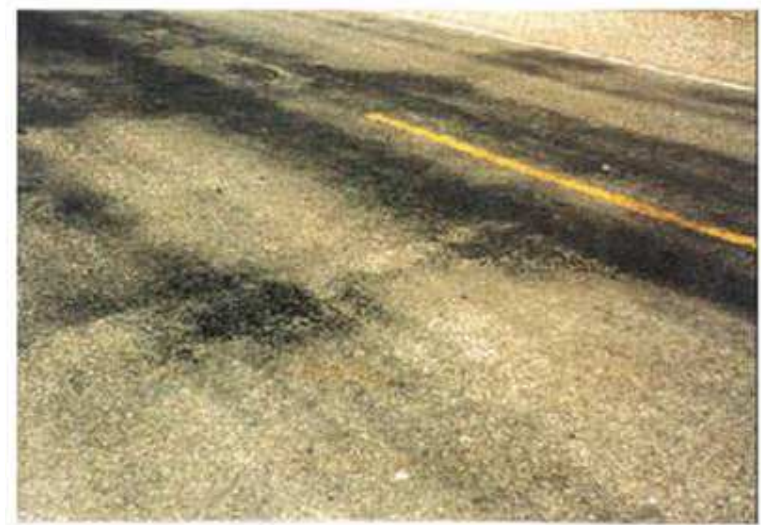
FOTO N° 1 Peladura Superficial FOTO N° 2 Exudación de Asfalto
