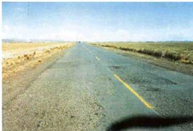
FOTO N° 6 Parchados con peladura o desgaste superficial.
