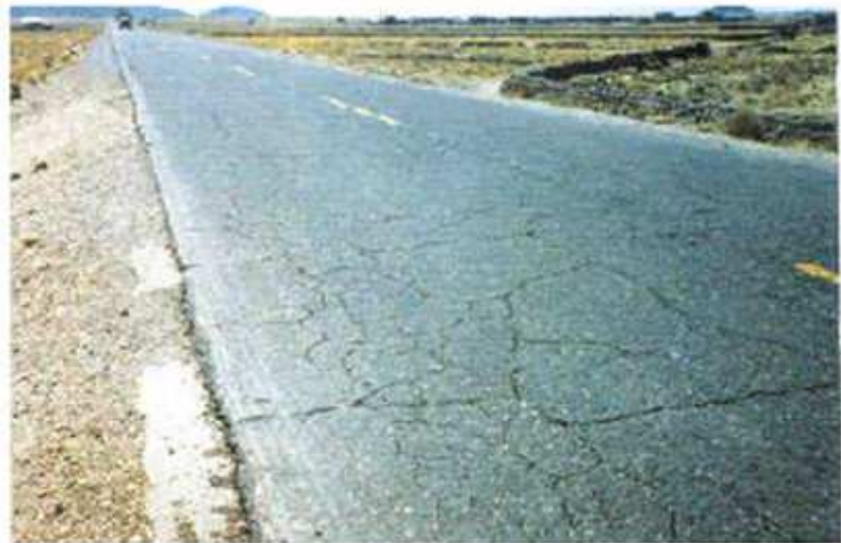
CONDICION N° 7 Moderado (--) CONDICION N° 8 Malo.
