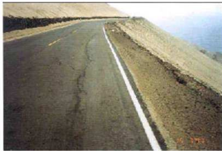
CONDICION N° 5 Moderado CONDICION N° 6 Moderado (-).
