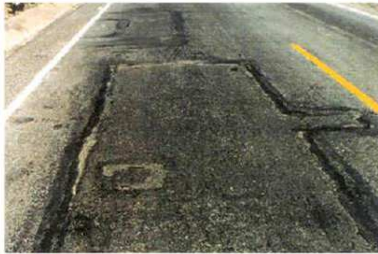
FOTO N° 5 Parchado mal conformado
