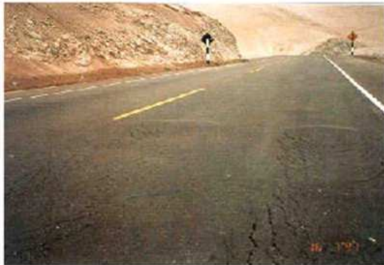
FOTO N° 4 Ondulación y corrimiento de la carpeta asfáltica.
